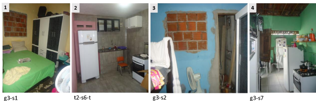
Figura Ap. 10- [G,T] - Retirada de esquadria devido à ampliação, 1, 2 fechamento com alvenaria; 3 - fechamento de janela e abertura de porta de comunicação entre ambiente construído; 4 - retirada para deixar vão aberto entre área ampliada.
