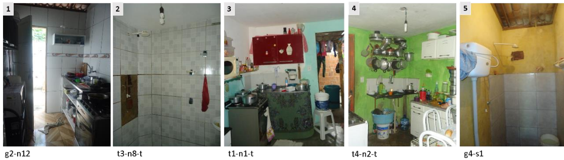
Figura Ap. 11 - [G,T] - Retirada de cobogó cozinha e banheiro, 1,2 fechamento com cerâmica; 3 - fechamento com mobiliário; 4- fechamento com utensílios; 5- fechamento improvisado.
