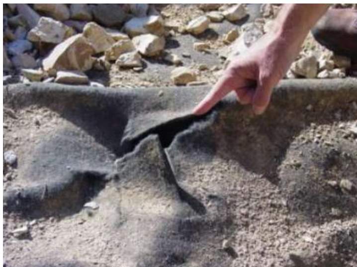
Figura 23: Manta geotêxtil com rasgo.
