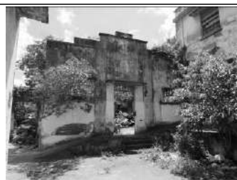
Imagem 27: Fachada frontal interna (ao lote) do edifício Norte da antiga IVS. Destaca-se a quantidade de manifestações patológicas.
