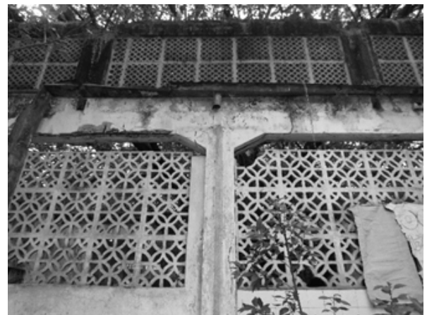
Imagem AP-D 05: Interior do edifício Nordeste. Destaca-se parede com fenestração com planos de cobogós.
