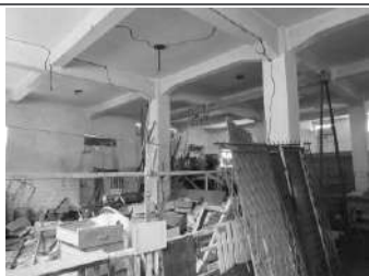
Imagem 06: Setor do Guaraná (13). Destaca-se as manifestações patológicas (fissuras no teto e na estrutura) e os entulhos.
