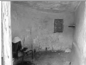
Imagem 02: Guarita (01). Destaca-se a utilização parcial de sua área para abrigar um quarto.
