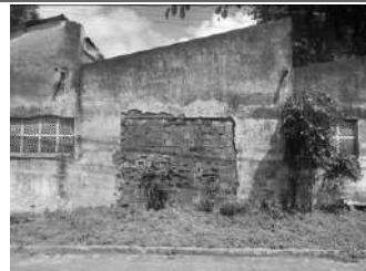
Imagem 16: Fachada frontal do edifício Nordeste da antiga IVS, rua Professora Analice Caldas. Destaca-se a abertura que sugere uma antiga porta, vedada com tijolos 8 furos.
