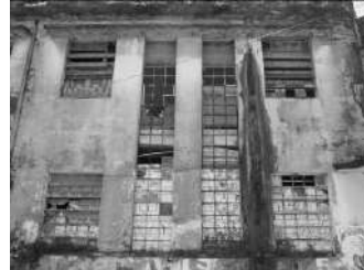
Imagem 12: Fachada lateral do edifício Leste da antiga IVS. Destaca-se a péssima situação das esquadrias.
