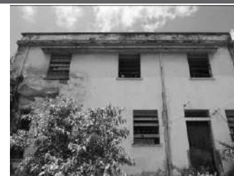
Imagem 08: Fachada lateral interna (ao lote) do edifício Leste da antiga IVS. Destaca-se as esquadrias do pavimento superior.
