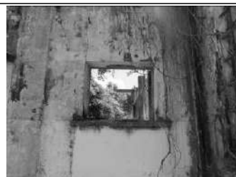
Imagem 33: Manifestações patológicas no interior do edifício Norte da antiga IVS.
