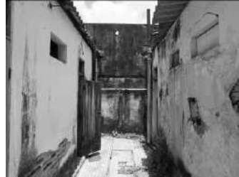
Imagem 11: Corredor entre os banheiros (10). Destaca-se o descolamento em placa e por empolamento.
