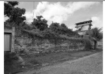
Imagem 21: Fachada do edifício Oeste da antiga IVS. Destaca-se o trecho em ruínas.
