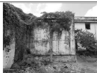
Imagem 29: Manifestações patológicas nos edifícios Norte e Oeste da antiga IVS.
