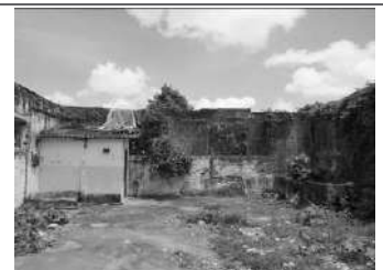
Imagem 25: Fachada lateral interna (ao lote) edifício Oeste da antiga IVS. Destaca-se as manifestações
