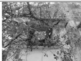
Imagem 32: Manifestações patológicas no edifício Norte da antiga IVS.
