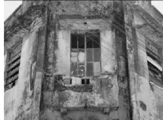
Imagem 11: Fachada frontal principal do edifício Leste da antiga IVS. Destaca-se a varanda do primeiro pavimento em arruinação.
