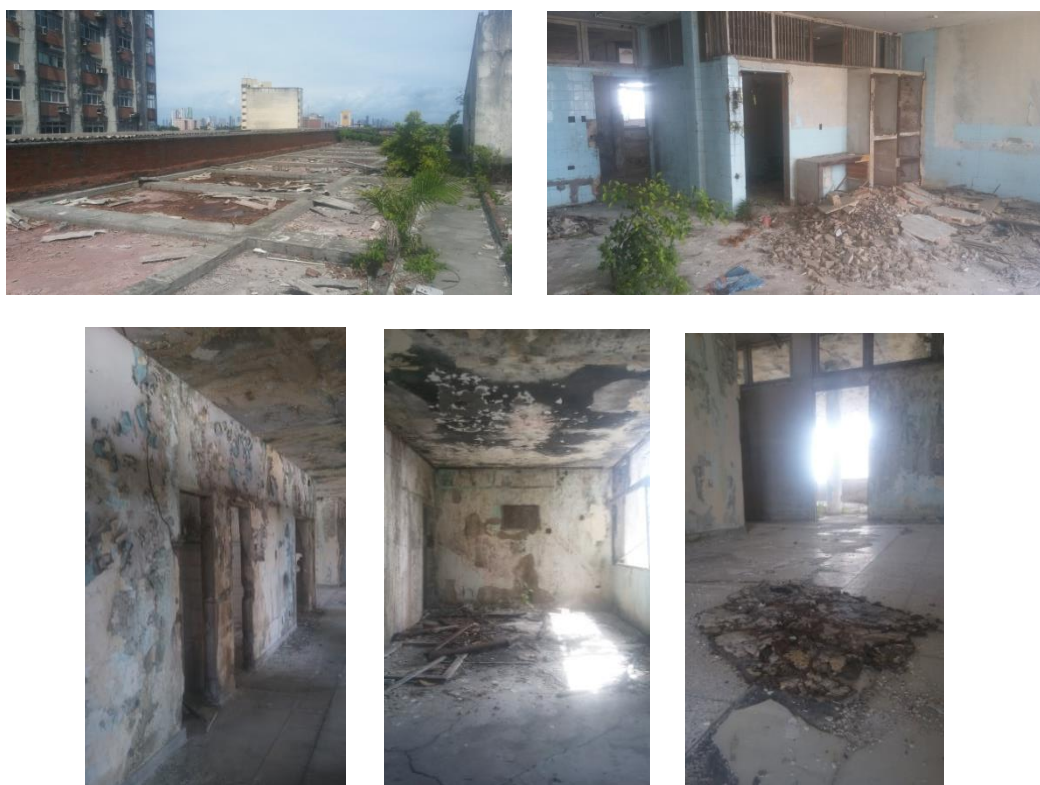
Figuras 27, 28, 29, 30 e 31: Ambientes internos do edifício IPASE – péssimo estado de conservação.
