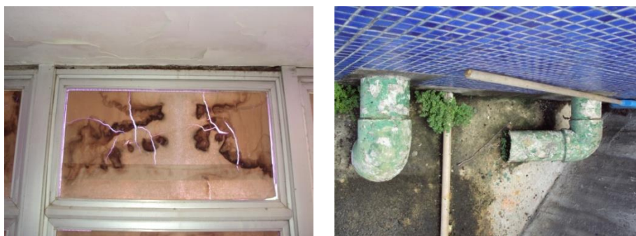
Figura 38: Detalhe do estado de degradação das esquadrias. Figura 39: Infiltração nos canos das cobertas.
