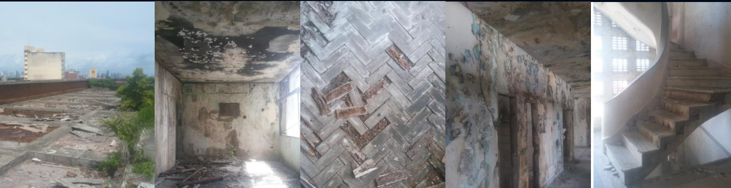
IMAGEM 05: Inexistência da coberta. IMAGEM 06: Patologias Internas. IMAGEM 07: Degradação Dos pisos originais. IMAGEM 08: situação paredes. IMAGEM 09: Situação escada.
